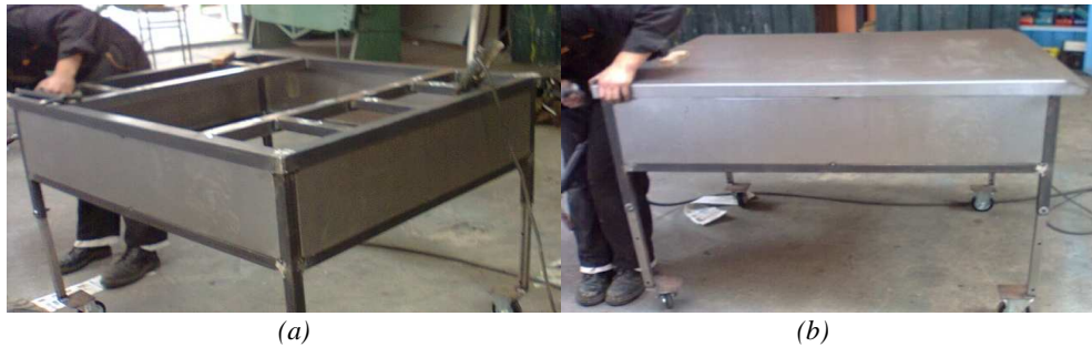
Figura 2.18 (a) y (b) colocación de la lámina de acero. Fuente: Los Autores
