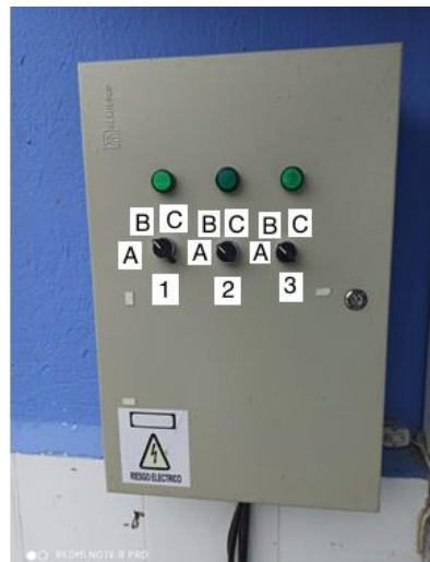
Figura 5. Caja de control.
