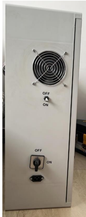
Figura 46. Dispositivos instalados en la parte lateral izquierda del gabinete
