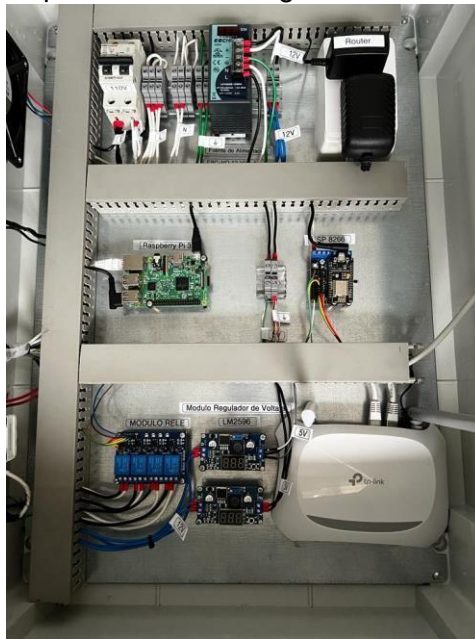
Figura 44. Dispositivos instalados dentro del Gabinete
