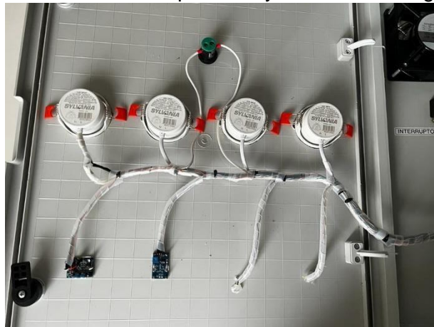
Figura 47. Conexiones y cableado del gabinete.
