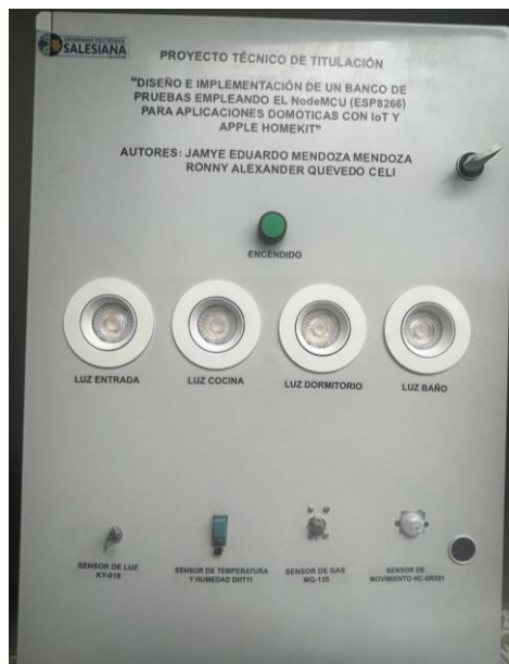
Figura 45. Dispositivos instalados en la parte Frontal del gabinete
