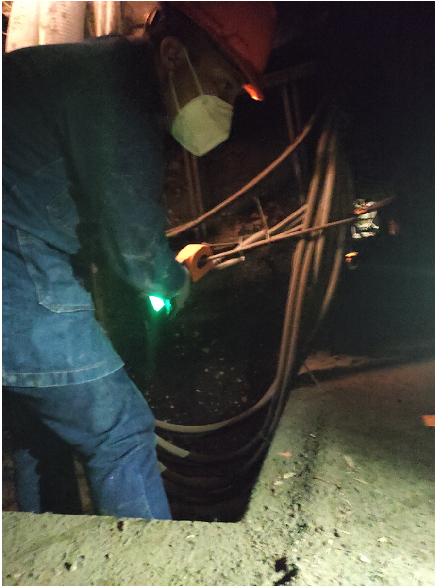
Figura 7.13: Medición de resistencia de malla puesta a tierra en derivación al grupo diésel.
