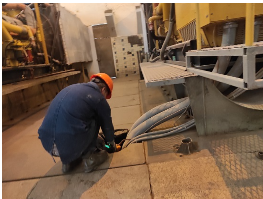
Figura 7.7: Medición de resistencia de malla puesta a tierra en derivación a generadores diésel
