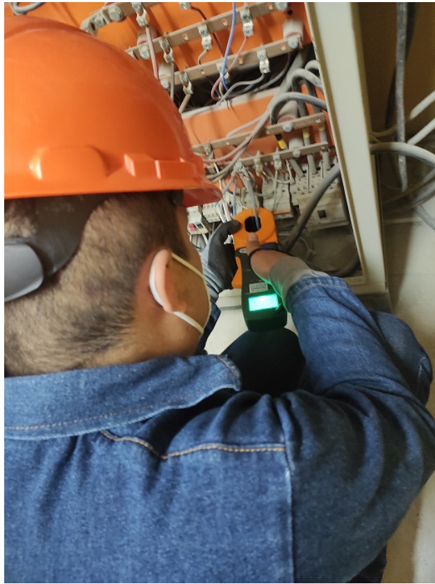
Figura 7.9: Medición de resistencia de malla puesta a tierra en derivación a tablero de distribución.
