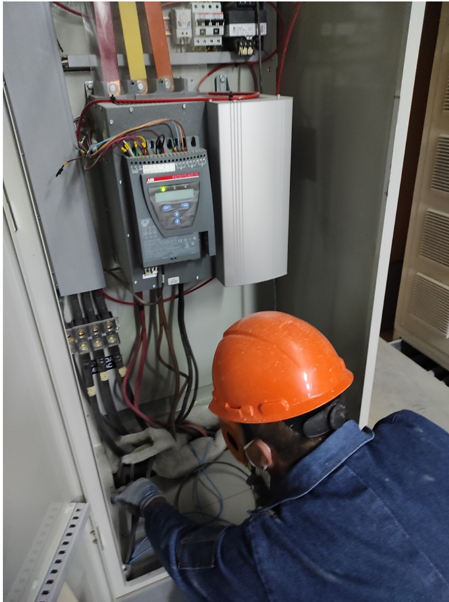
Figura 7.8: Medición de resistencia de malla puesta a tierra en derivación a variador de frecuencia
