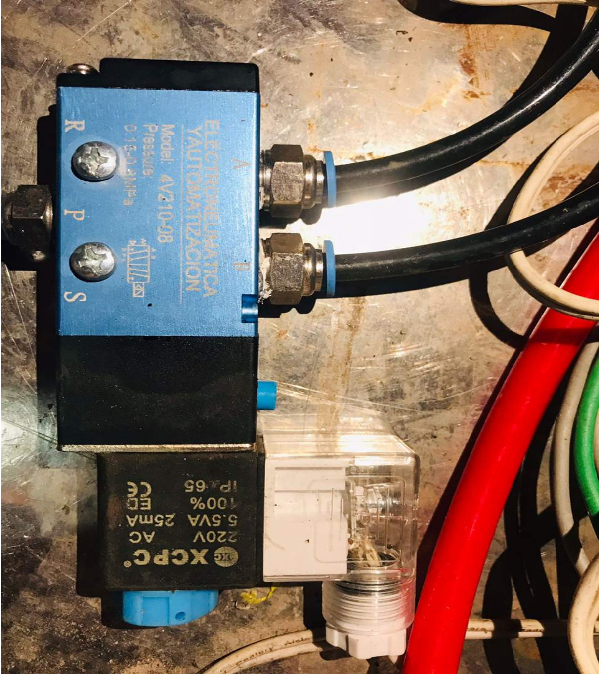
Figura 60. Prueba de electroválvulas.
