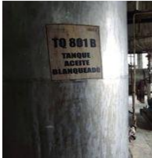
Foto 10: Tanque de almacenamiento de blanqueado
