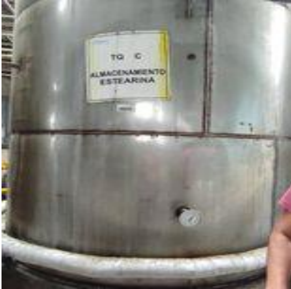
Foto 07: Tanque de almacenamiento de Estearina
