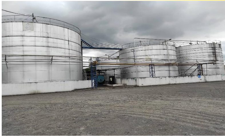
Foto 15: Taques de almacenamiento en general
