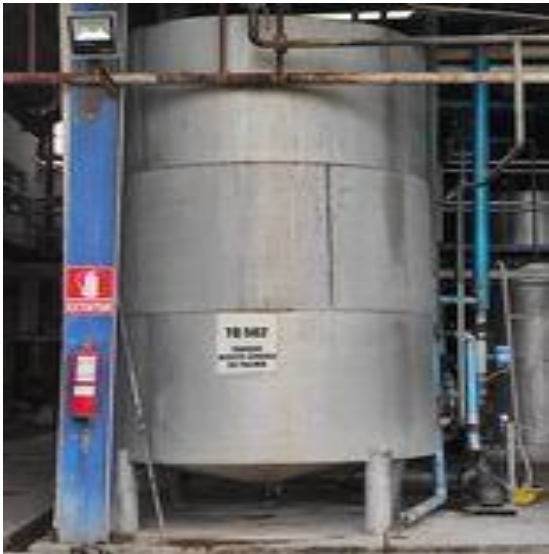
Foto 11: Tanque de almacenamiento de aceite crudo
