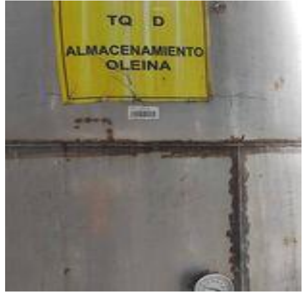
Foto 08: Tanque de almacenamiento de oleína
