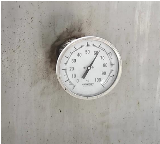
Foto 16: Temperatura del tanque de estearina
