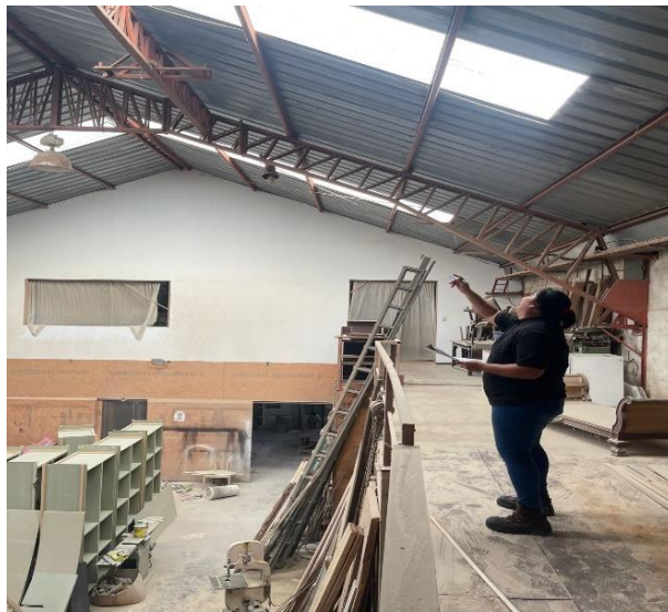
Ilustración 4: Techos en mal estado
