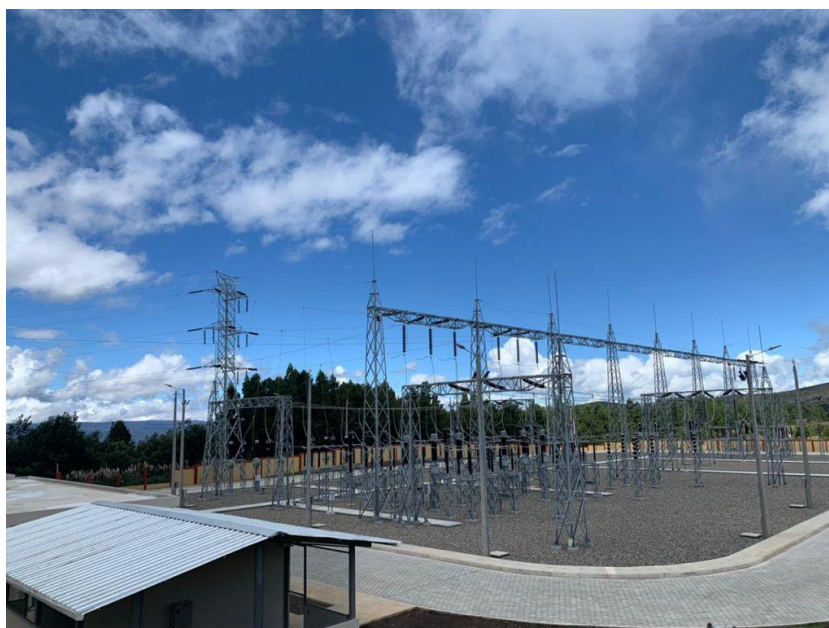
Figura 4.7: Subestación de seccionamiento La Paz.
