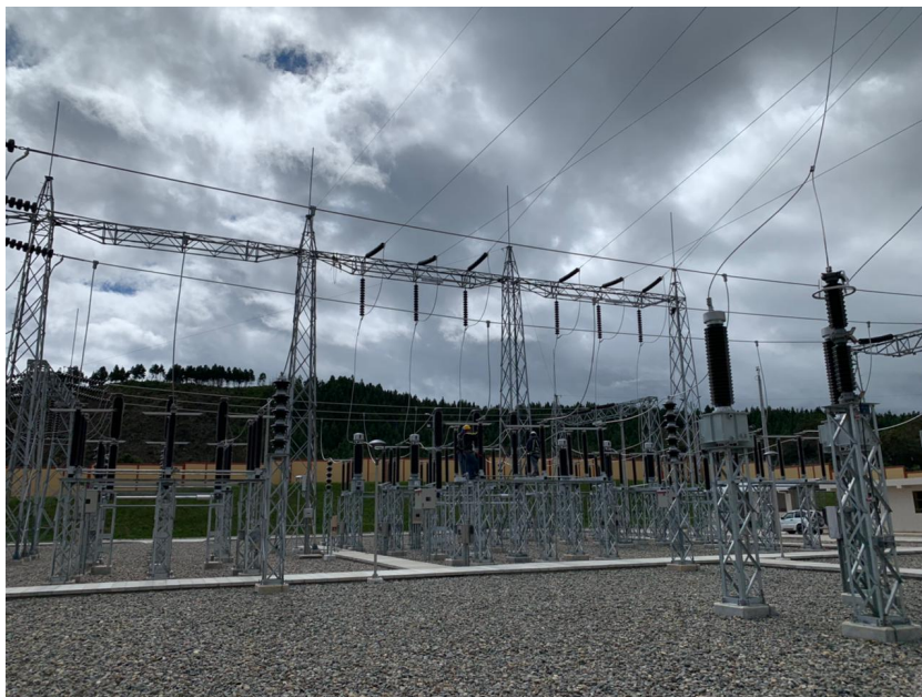
Figura 4.6: Subestación La Paz.
