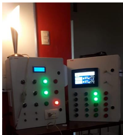
Figura 41: Funcionamiento de módulos
