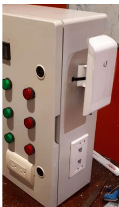
Figura 39: Instalación de antena y puertos de red para salidas en módulo Arduino
