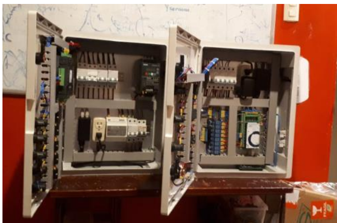
Figura 40: Armarios terminados por dentro
