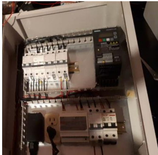
Figura 37: Cableado de tablero metálico Unitronics
