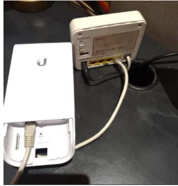
Figura 50: Conexión entre antena con router con acceso a internet.
