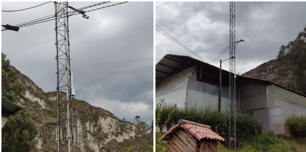
(a) Gateway colocado en la torre. Vista 1
