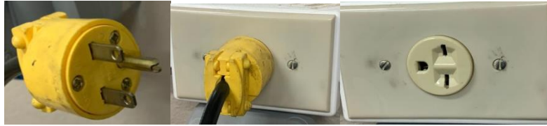
Ilustración 5: Conexión de tomacorriente 220V.
