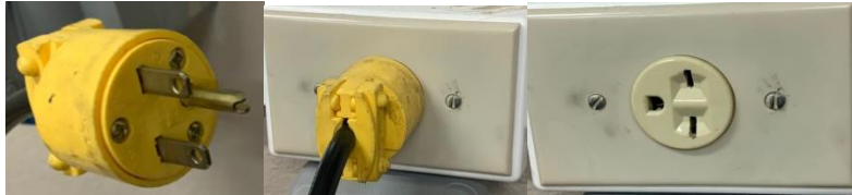
Ilustración 5: Conexión de tomacorriente 220V
