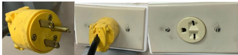
Ilustración 5: Conexión de tomacorriente 220V
