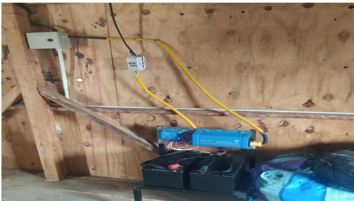
Figura 38. Sistema fotovoltaico instalado en una vivienda de Masa 2.
