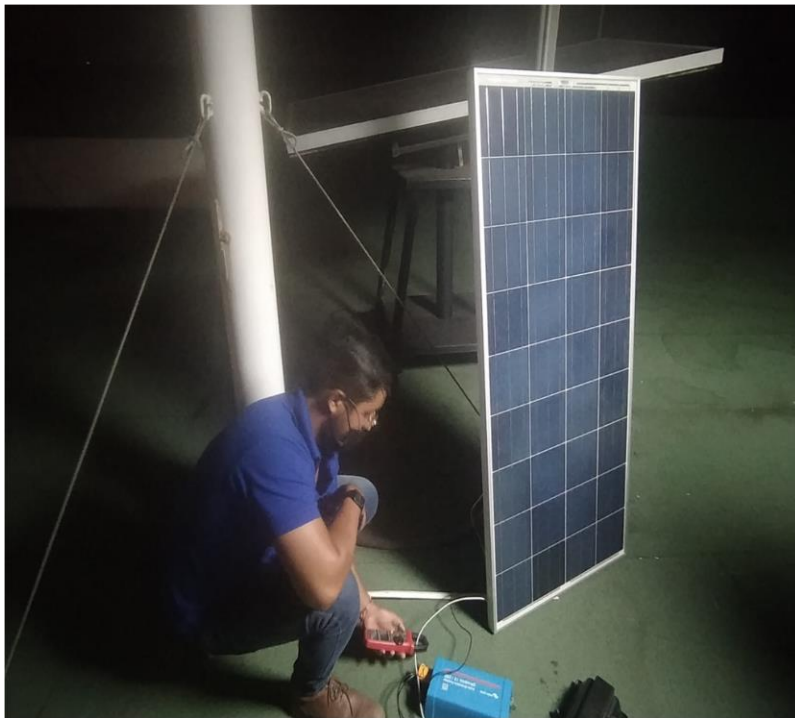
Figura 49. Verificación de que el panel fotovoltaico no genera energía por la noche.
