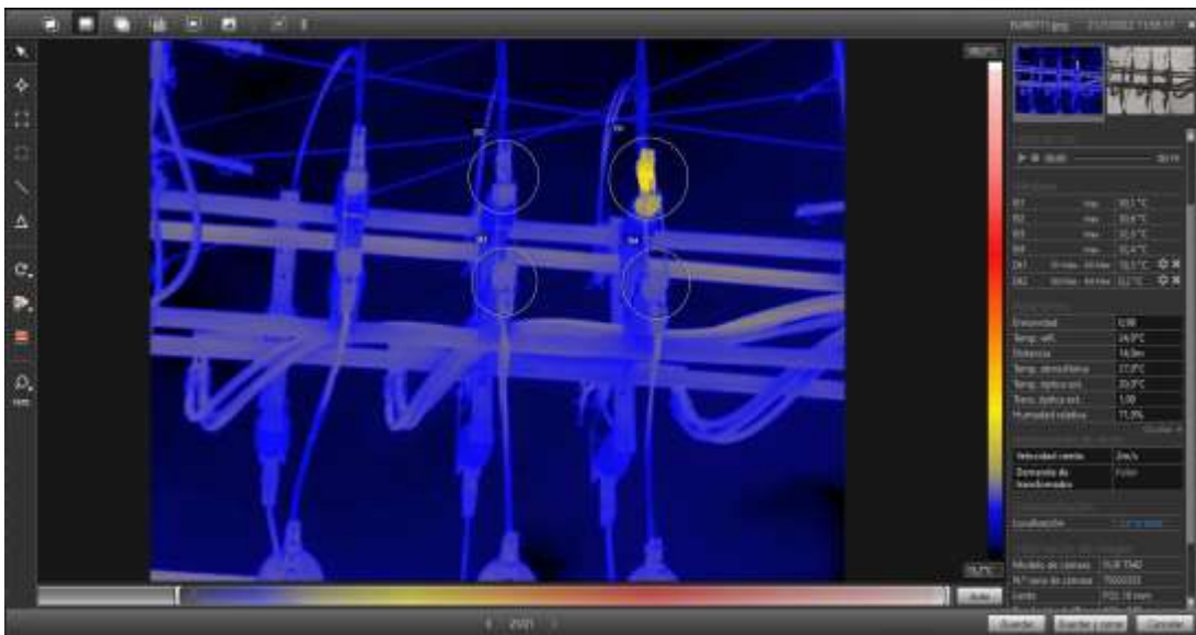
FIG. 13. DIAGNÓSTICO BASADO EN EL AUMENTO DE LA TEMPERATURA SEGÚN ANSI/NETA ATS-2009: TABLA 100.18 (THERMOGRAPHIC SURVEY SUGGESTED ACTIONS BASED TEMPERATURE RISE).
