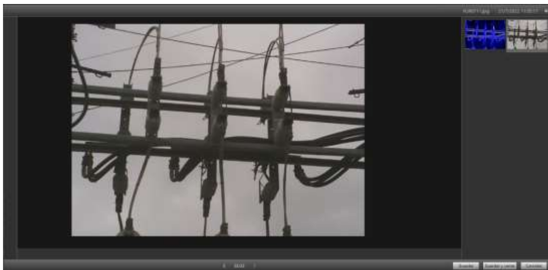
FIG. 9. DESCARGA DE IMÁGENES DEL PUNTO CALIENTE A TRABAJAR EN EL SECCIONADOR TIPO BARRA, FASE A, PATIO B, SUBESTACIÓN DURAN SUR
