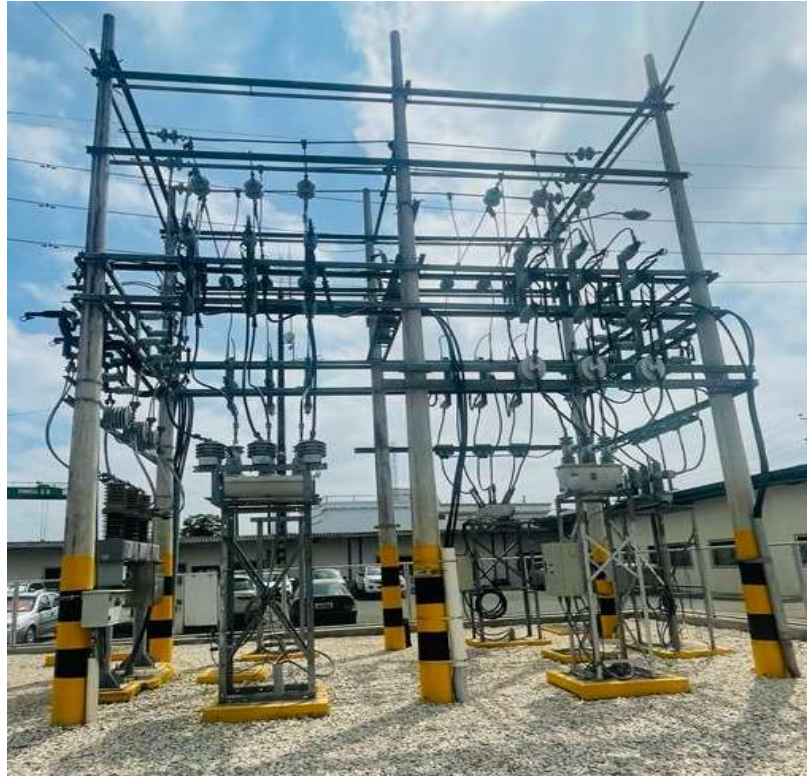
Información obtenida en el Patio B la Subestación Duran Sur.
