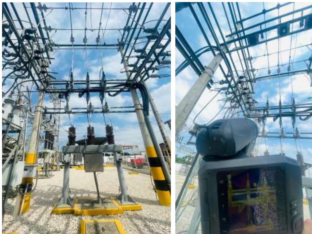
FIG. 7. CAPTACIÓN DE TOMA TERMOGRAFÍA DEL SECCIONADOR TIPO BARRA, FASE A, PATIO B, SUBESTACIÓN DURAN SUR
