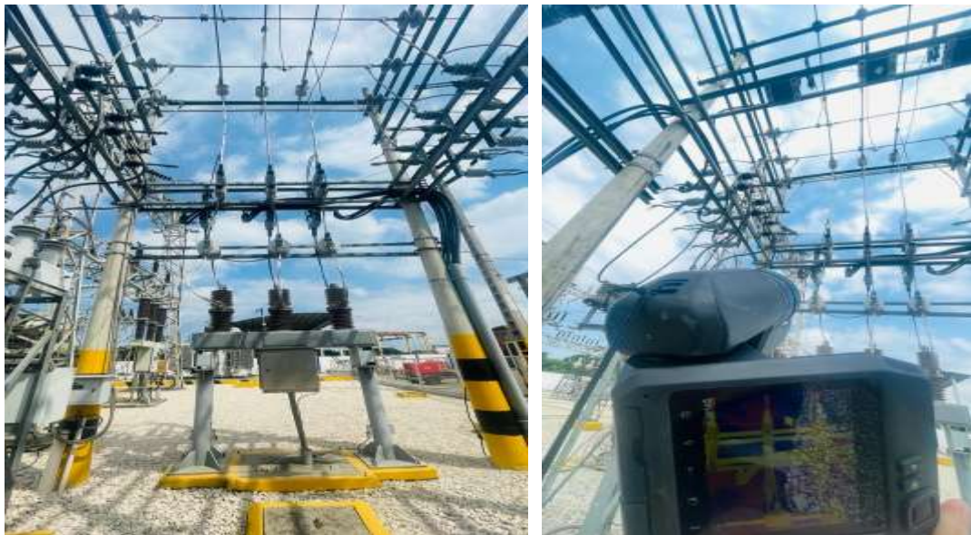
Información obtenida en el Patio B la Subestación Duran Sur.
