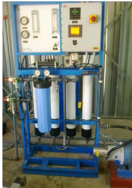
Figura 2 Planta desalinizadora por Osmosis Inversa de 38 metros cúbicos
