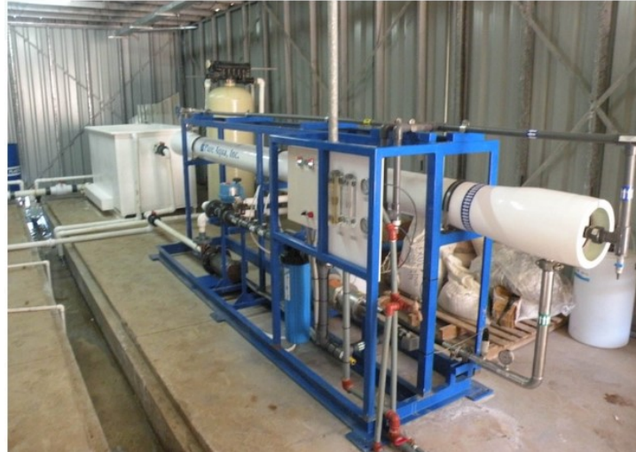
Figura 3 Planta desalinizadora por Osmosis Inversa de 59 metros cúbicos
