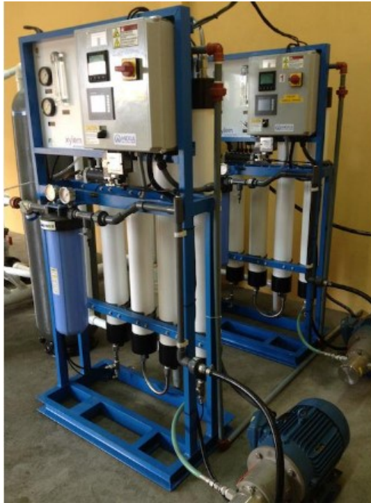
Anexo 1 Planta desalinizadora por Osmosis Inversa de 38 metros cúbico/día
