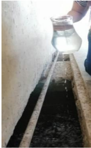
Captación (Agua Cruda)
