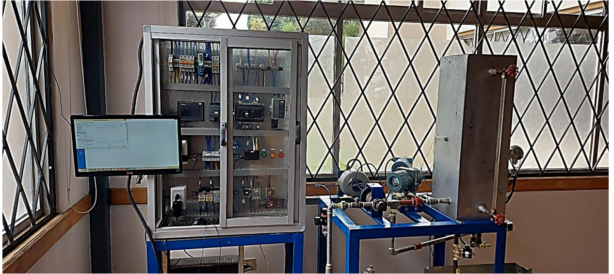
Figura 58. Tablero de control
