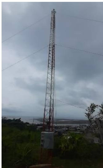
Ilustración 2 Torre de telecomunicaciones Palestina. Elaborado por: Aldair Santos
