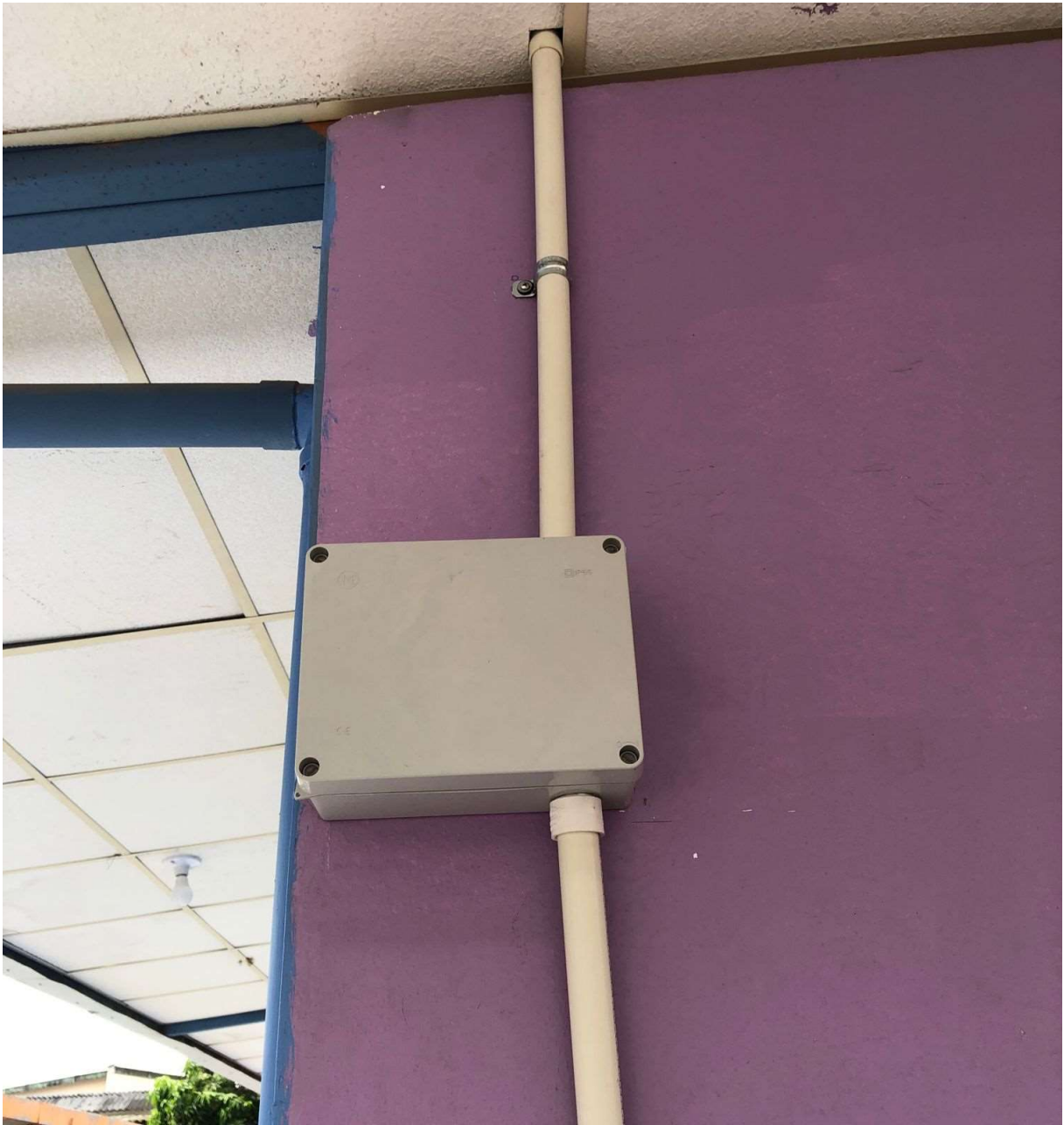
Figura 61. Caja de paso con borneras del cable viajero
