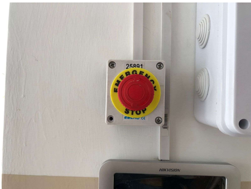
Figura 43. Paro de emergencia físico
