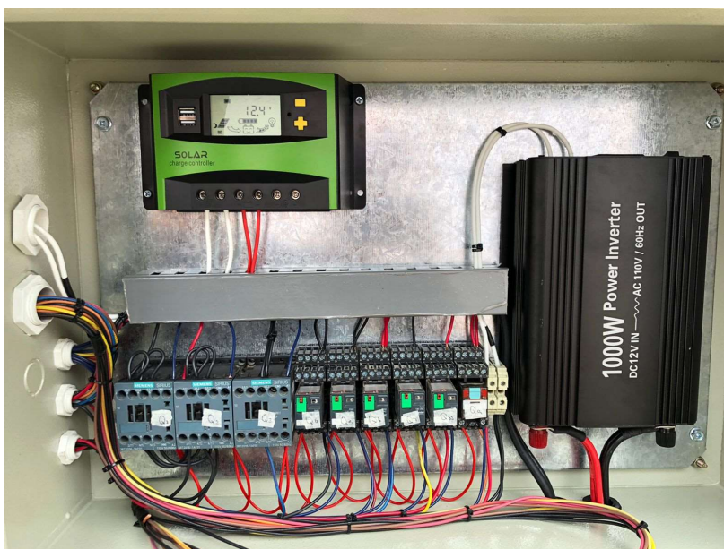
Figura 45. Tablero final del sistema fotovoltaico
