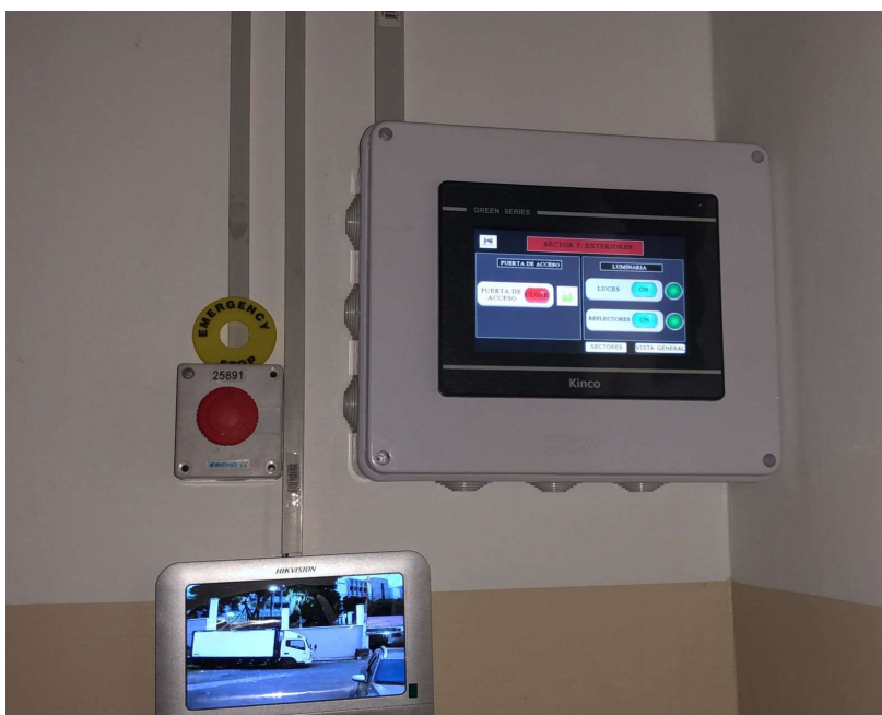
Figura 46. Pantalla HMI y Paro de emergencia implementados
