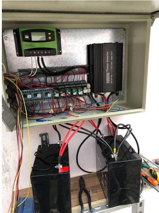
Figura 39. Sistema de baterías e inversor
