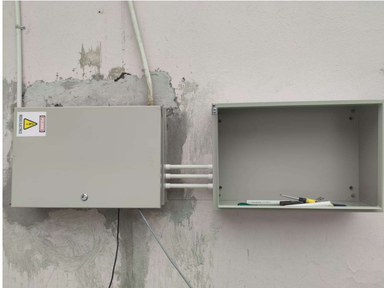
Figura 58. Tablero del sistema fotovoltaico vacío
