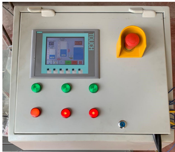
Figura 35. Tablero de control eléctrico
