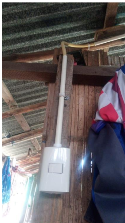
Imagen 44. Conexión de interruptores Fuente: Participantes del proyecto
