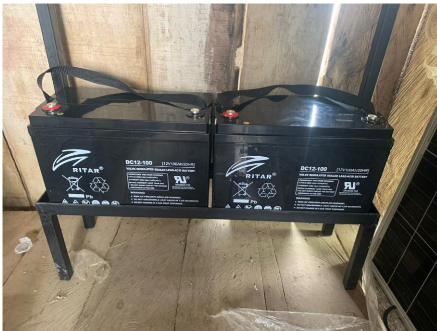
Imagen 48. Conexión serie de las baterías
