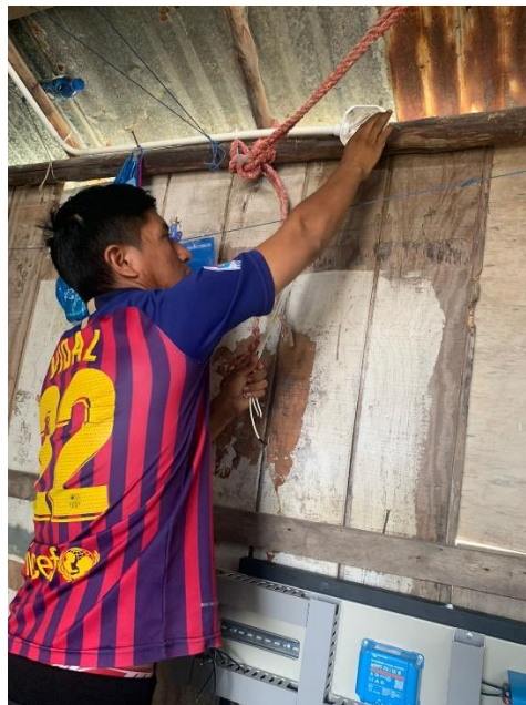
Imagen 41. Circuitos de tomacorrientes e iluminación
