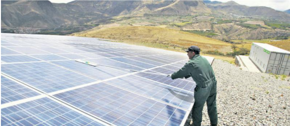
Imagen 6. Planta fotovoltaica en la provincia de Pichincha
