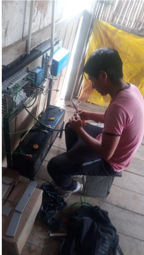
Imagen 42. Cableado de los circuitos de iluminación y tomacorrientes
