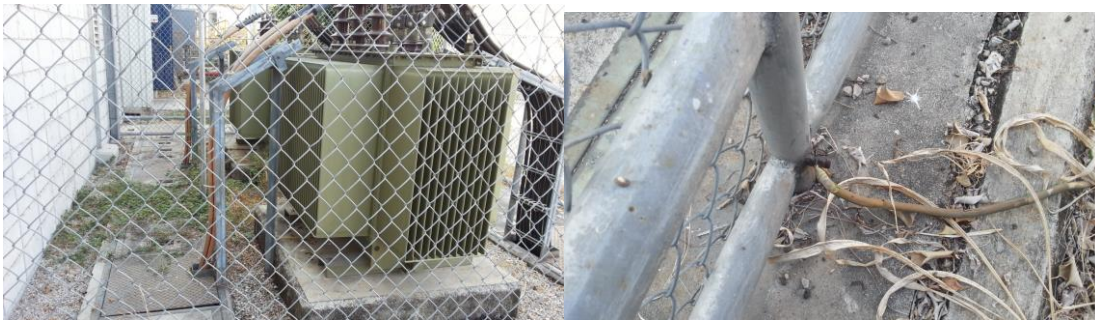
Imagen 20. Cuarto de Transformador. [16]
