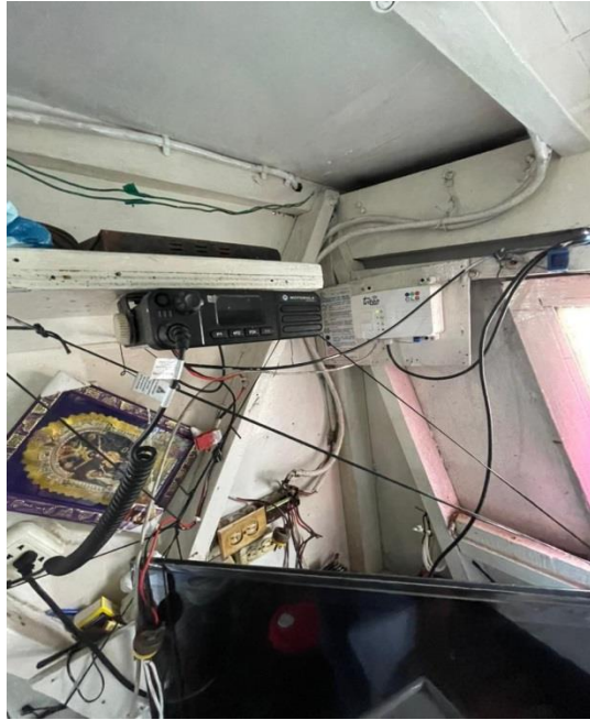
Mal estado de las instalaciones y del cableado.
