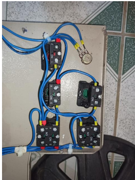
Figura 51. Cableado de elementos para el control del Variador de Frecuencia
