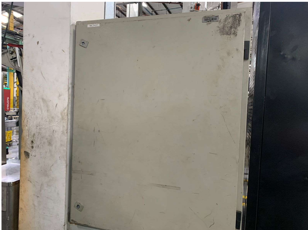
Figura A.10 Cajetín de PLC-7
