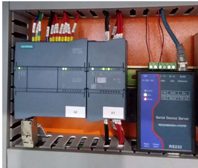
Figura 3.29 Conexión de sensores al PLC-1
