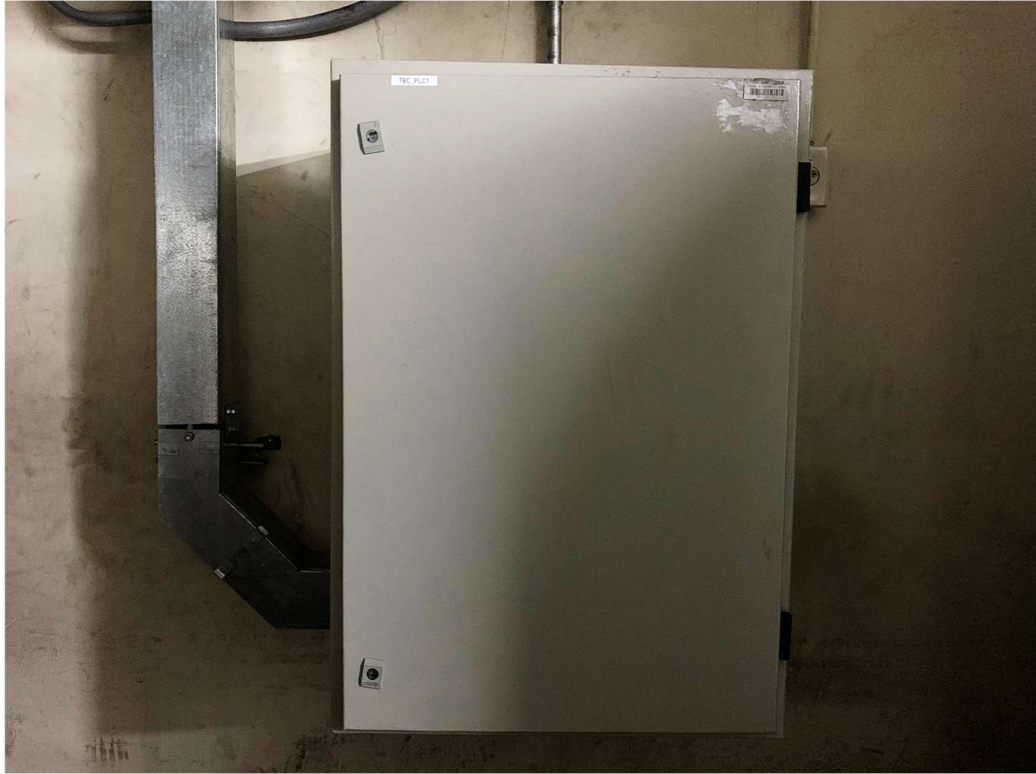
Figura A.5 Cajetín de PLC-1
