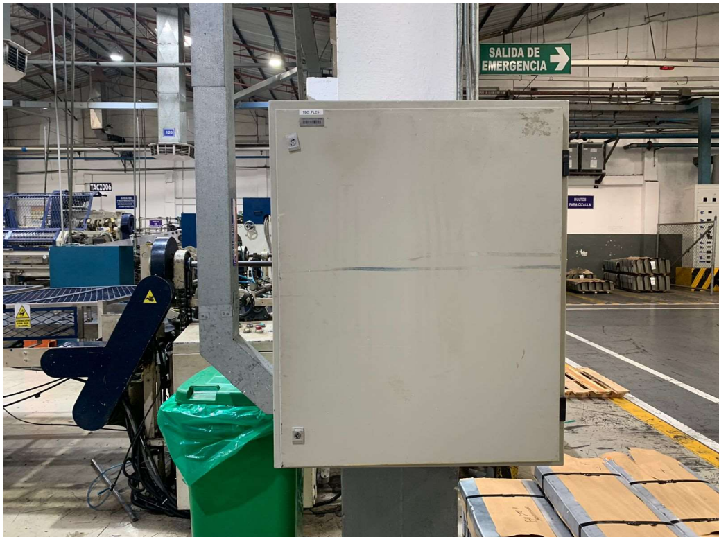
Figura A.8 Cajetín de PLC-5
