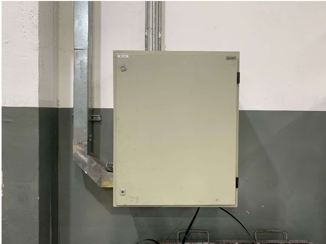
Figura A.7 Cajetín de PLC-4
