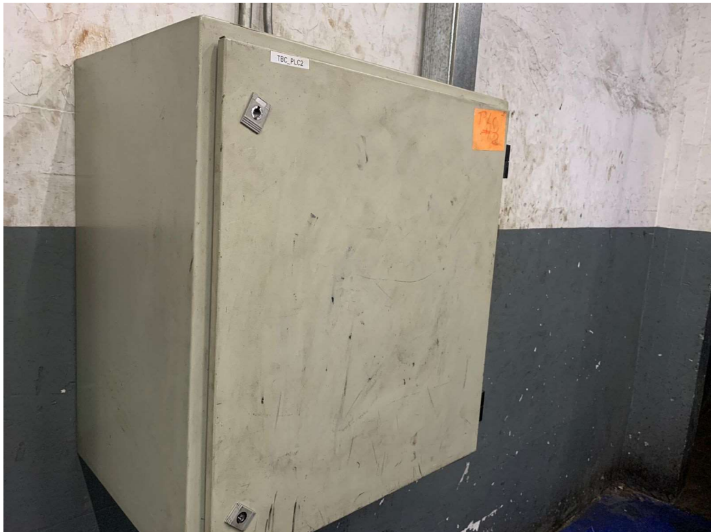
Figura A.6 Cajetín de PLC-2
