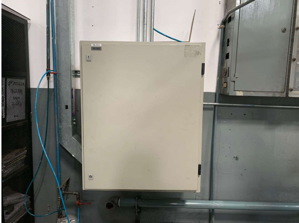
Figura A.9 Cajetín de PLC-6
