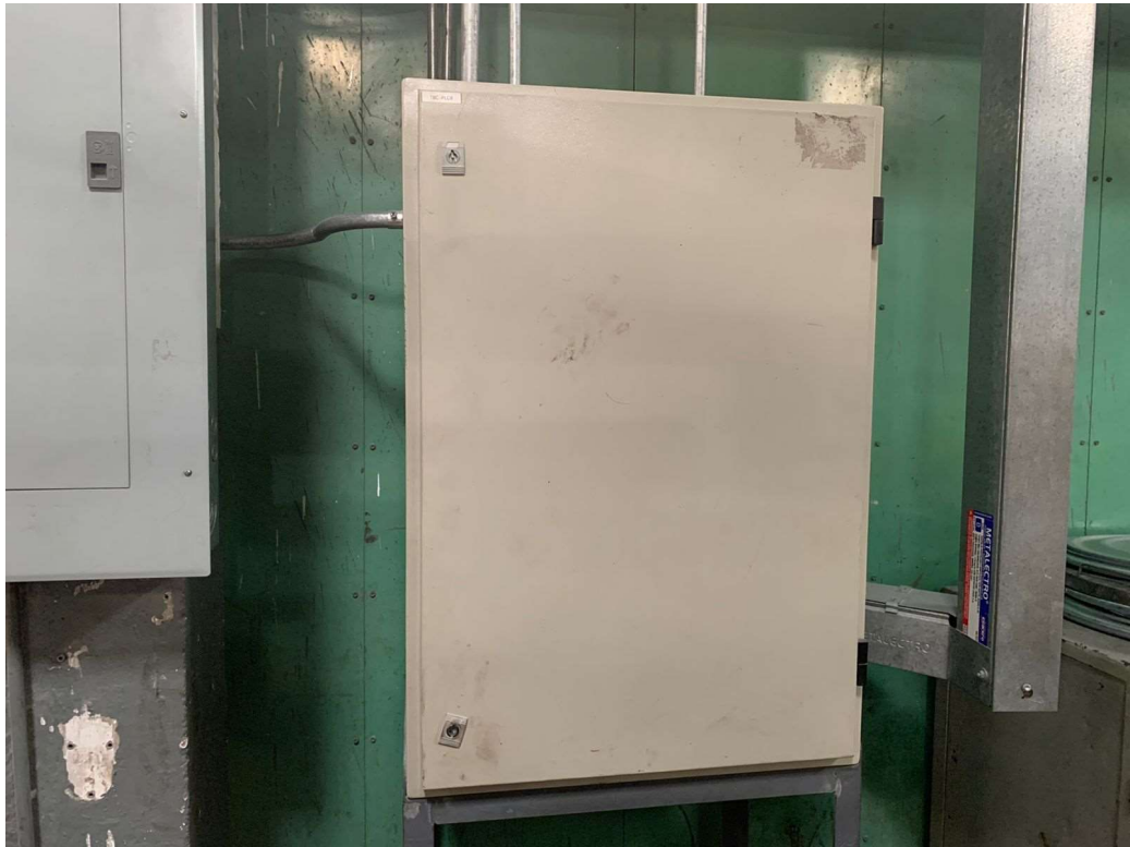
Figura A.11 Cajetín de PLC-8
