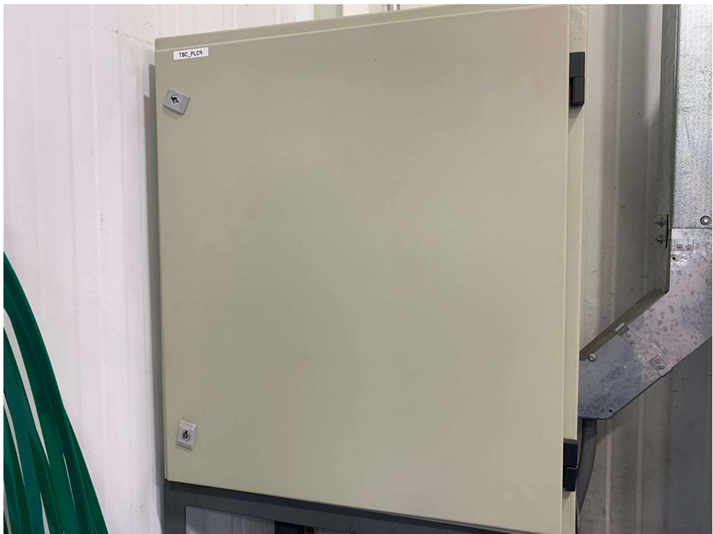
Figura A.12 Cajetín de PLC-9
