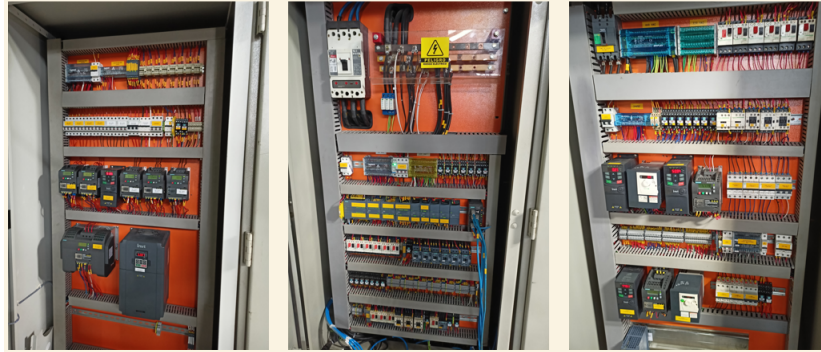
Figura 3.12: Paneles eléctricos actuales Palinox-2.
