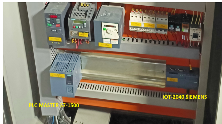
Figura 3.130: Instalación IOT-2040 Siemens.
