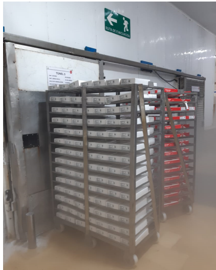
Figura 4.9: Coches ingreso a túneles de congelación.
