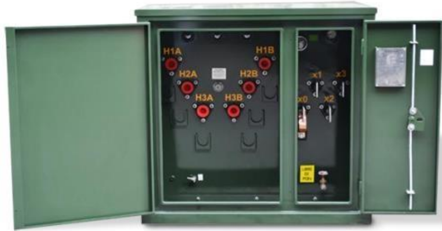
Figura 14 Transformador trifásico pad mounted. Fuente: Grupo Inproel, filial Moretran (2021).
