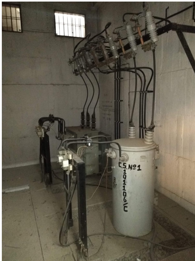
Anexo 2 Tranformador 75 kVA
