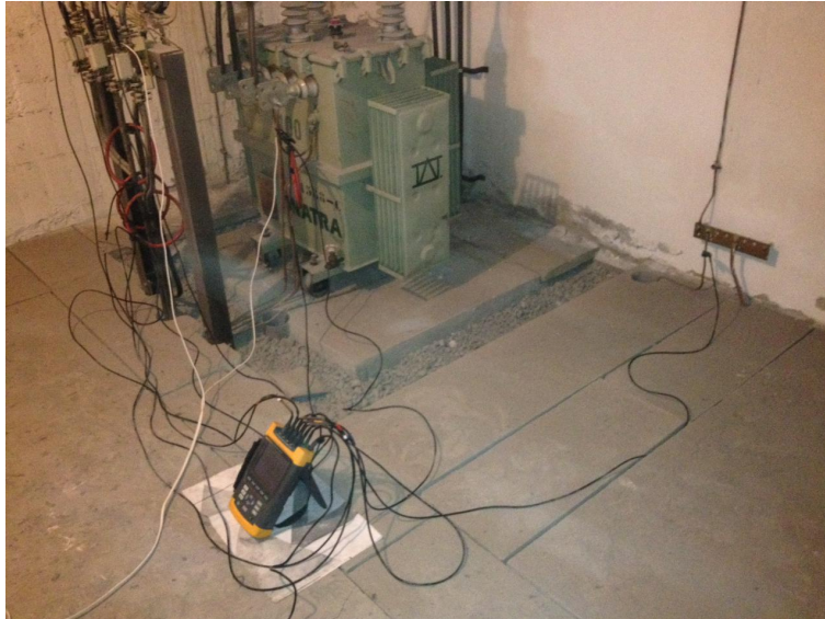
Figura 15 Medición transformador trifásico de 100 kVA. Fuente: Autor.
