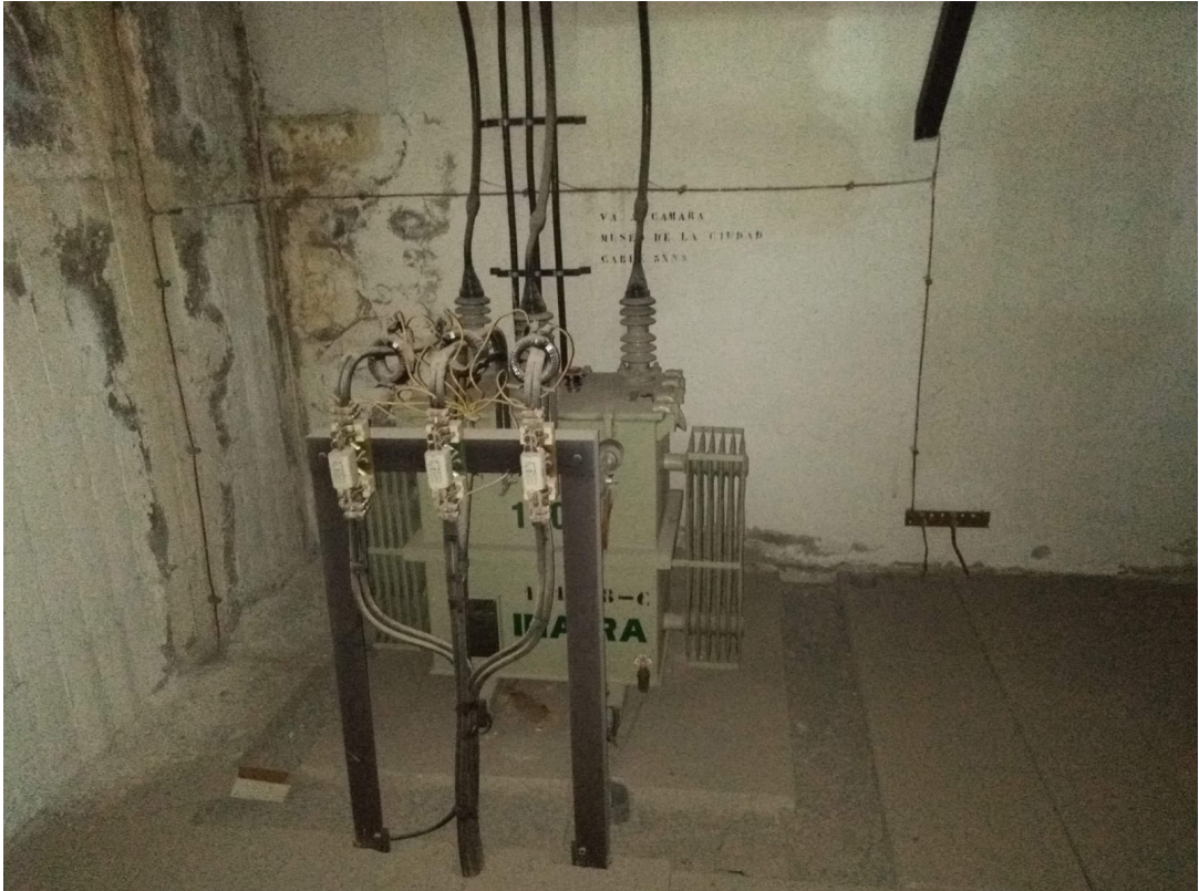
Anexo 3 Tranformador 100 kVA. Nota: Fuente: Autor
