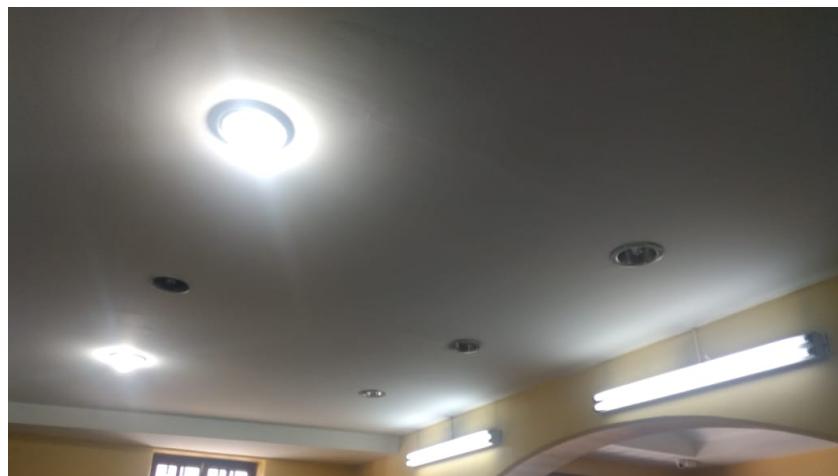
Figura 12 Iluminación del centro de salud.
