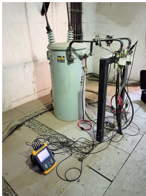
Figura 14 Medición transformador bifásico de 75 kVA.
