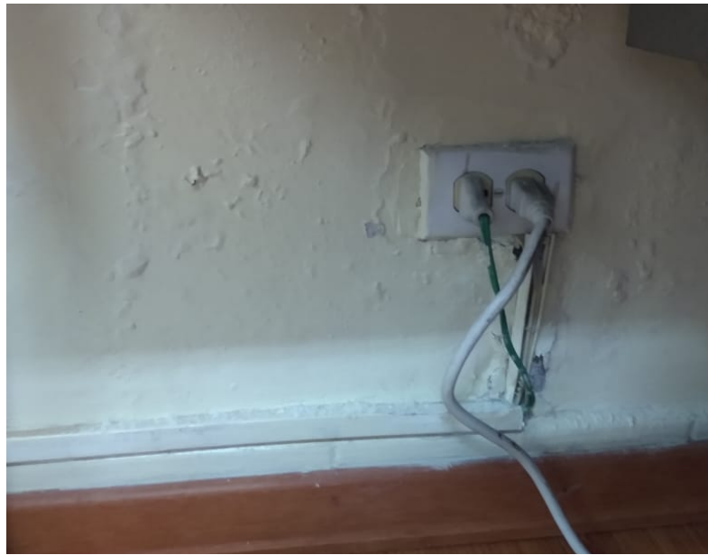
Figura 13 Estado de los toma corrientes.
