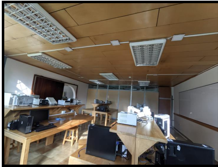
Luminarias instaladas con cables guiados en canaletas, Erick Anchali, David Estrella.
