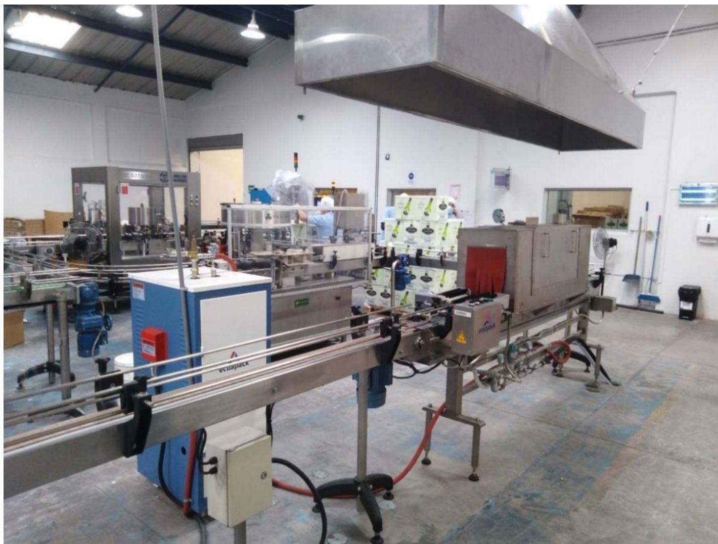
ANEXO 11. Túnel de calor instalado en su estación de servicio
