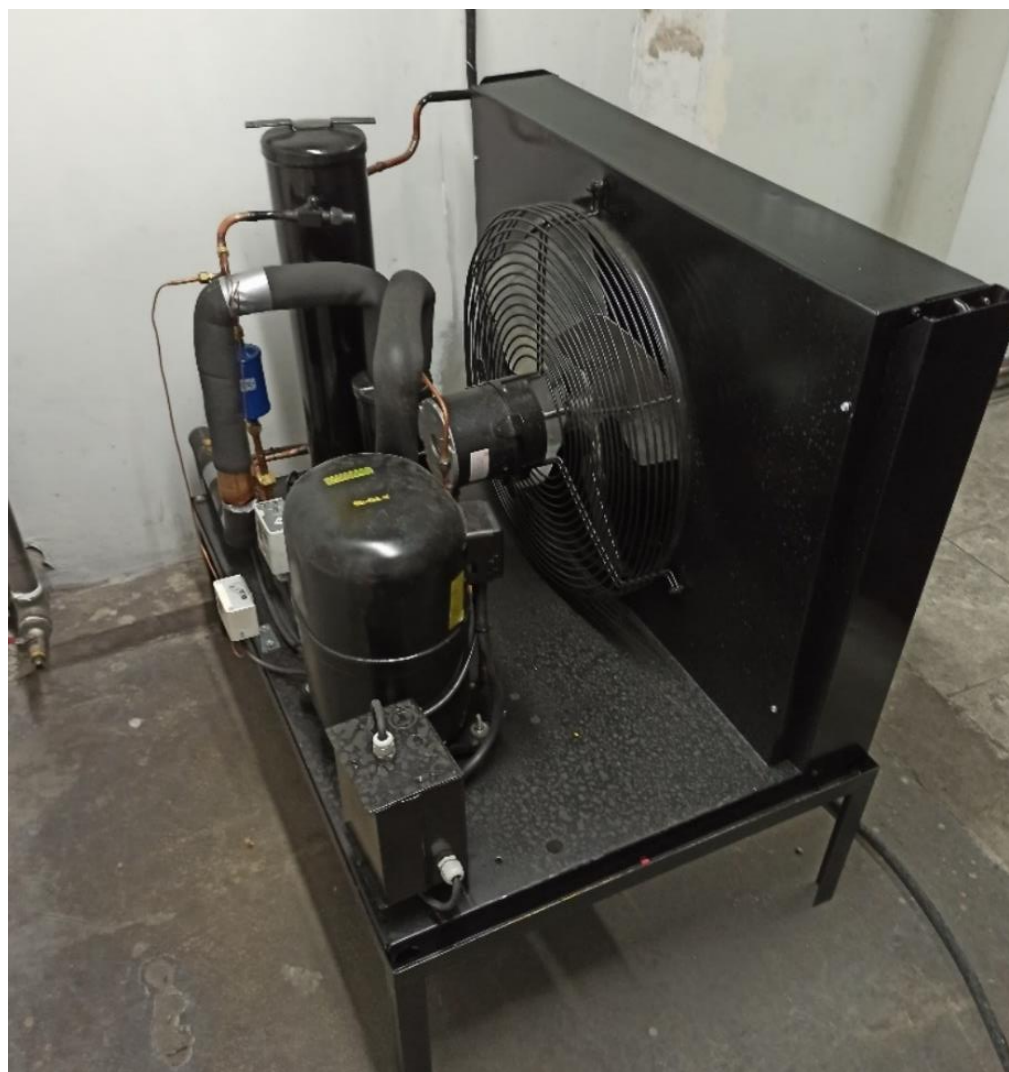
ANEXO 3. Unidad condensadora instalada en el área de compresores.
