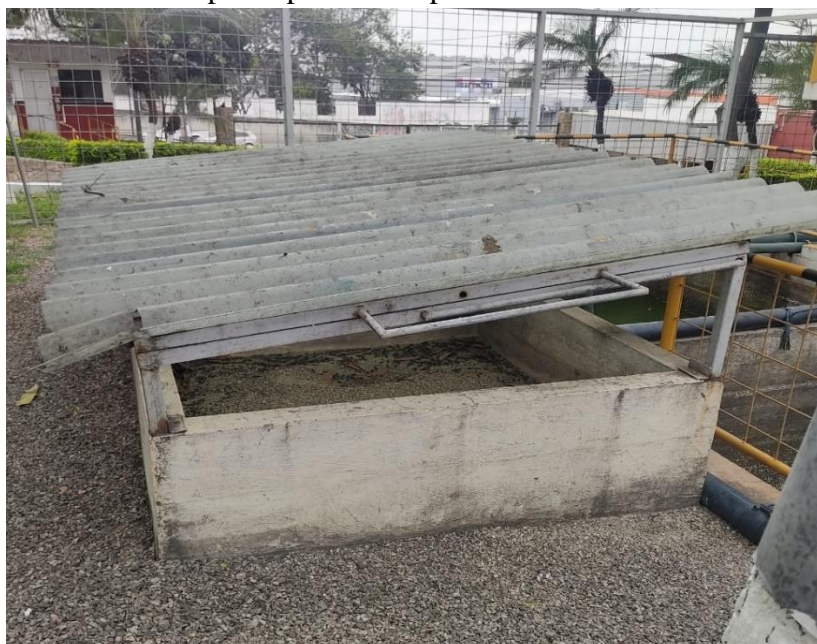
Figura 24. Piscina de respaldo pretendida para usar en el tratamiento de oxidación.
