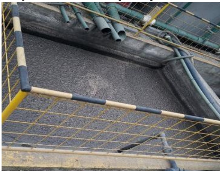
Figura 12. Aguas residuales en estanqueidad para efectivizar el proceso.
