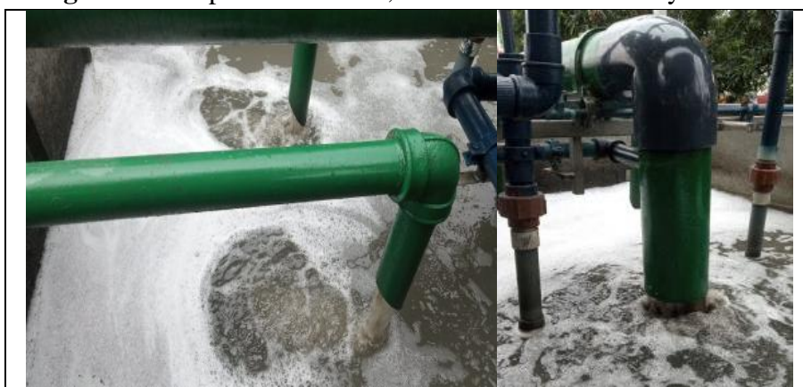
Figura 14. Etapa clarificadora, bombas activadas extrayendo lodos.
