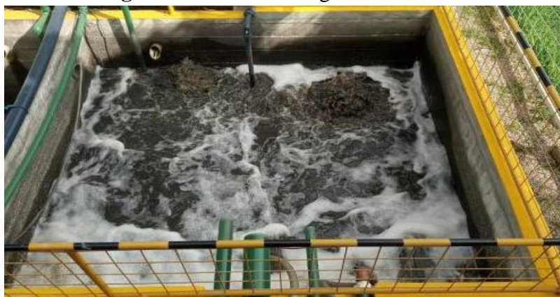
Figura 11. Piscina de digestores de lodo.
