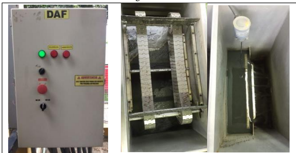
Figura 10. Panel de operaciones del DAF y sus bandas de rodamiento para la mezcla de las aguas con lodos.
