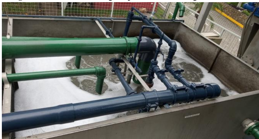
Figura 13. Reactor biológico procesando las aguas residuales.
