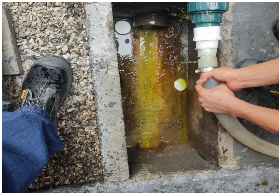
Figura 25. Adaptación de tubería al sistema de aguas residuales para llenado de tanque y recolección de muestras.
