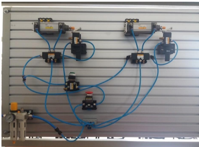
Figura 114. Implementación Neumática en el Módulo
