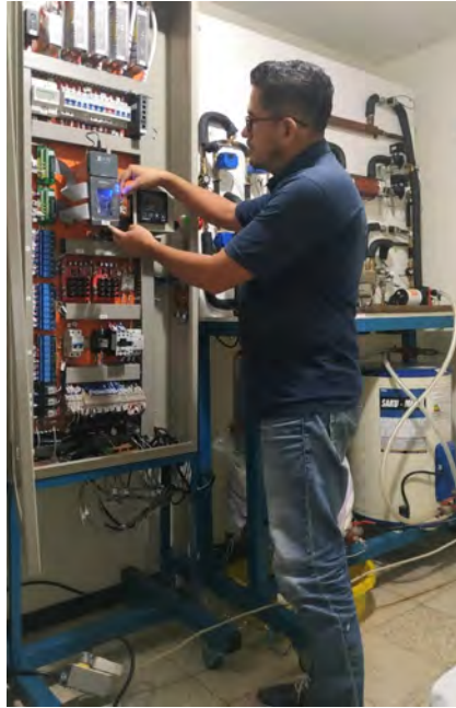
Figura 5.6: Verificación de los componentes de la Unidad de Control.
