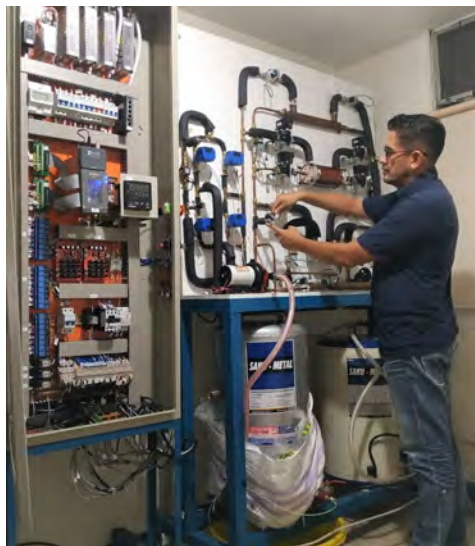
Figura 5.7: Verificación de los componentes de la Unidad de Servicio.
