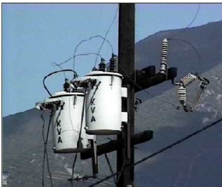
GRÁFICO #6.- TRANSFORMADORES TIPO TANQUE INSTALADOS EN POSTE
