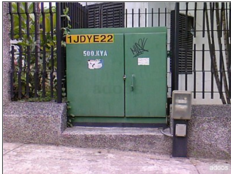
GRÁFICO #3.- TRANSFORMADORES TAP MOUNTED.
