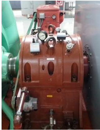
Figura 1.3: Cojinete de turbina hidráulica del grupo generador 6.
