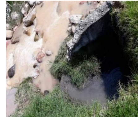
C. Descarga de aguas residuales provenientes del alcantarillado del centro parroquial de Sinincay
