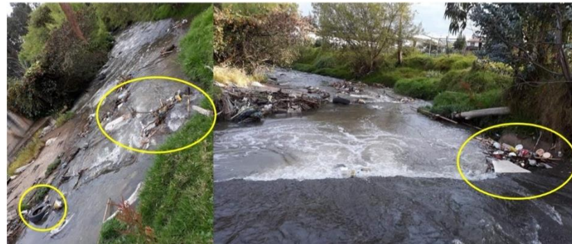
Ilustración 49: Presencia de residuos en la parte final del río Sinincay.
