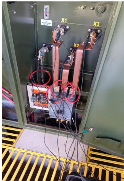
Figura 25. Conexión del analizador de energía FLUKE 435-I.
