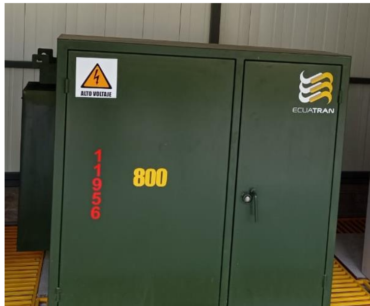
Figura 18. Transformador de 800 kVA.
