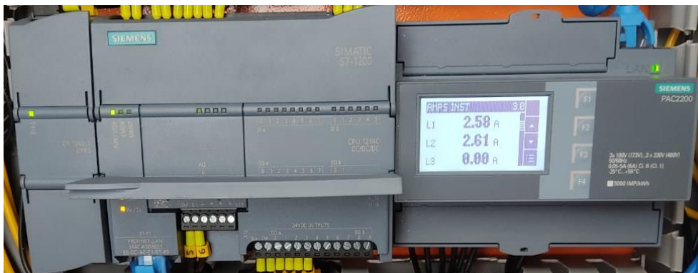
Figura # 216 Visualización de funcionamiento del PLC y Sentron PAC.
