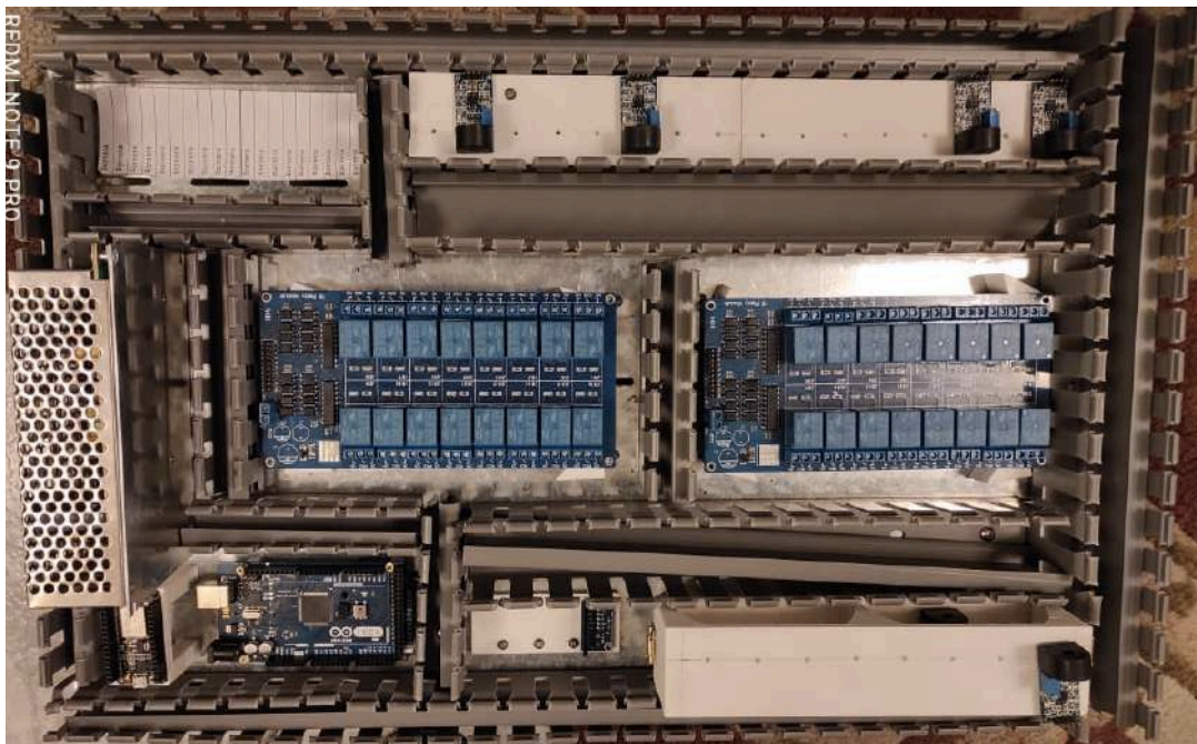
ANEXO XII. Tablero con Componentes Electrónicos.
