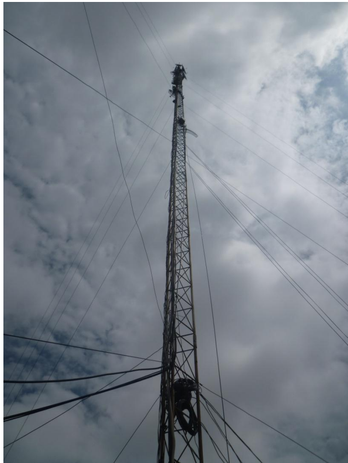
Anexo F.2 Torre CNEL El Oro
