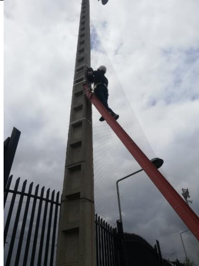
Figura 105 Conexión directa desde la NAP a la ONT bajo las medidas de seguridad recomendadas.
