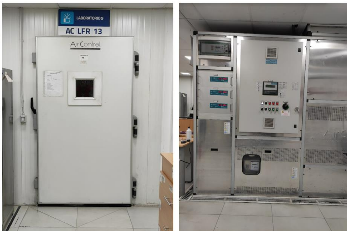
Cámara climatizada y panel de control
