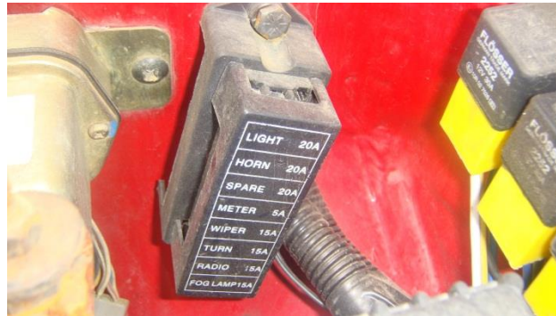
Figura 3 42 Caja de Fusibles Fuente: Los Autores
