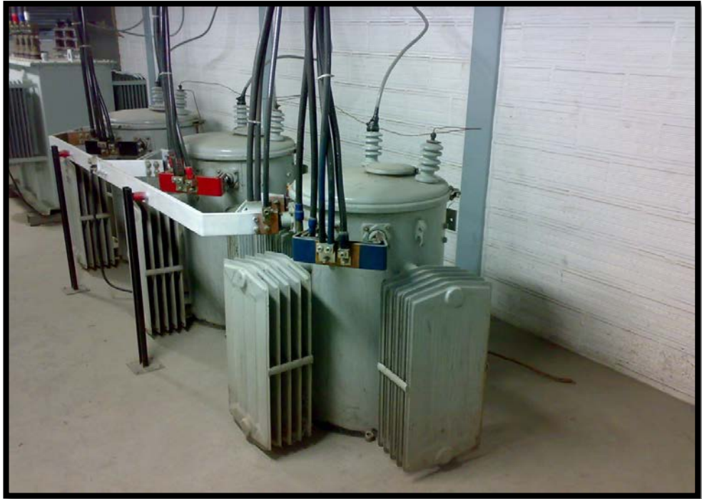
Ilustración 50: Cuarto de transformadores. Fuente: Autor
