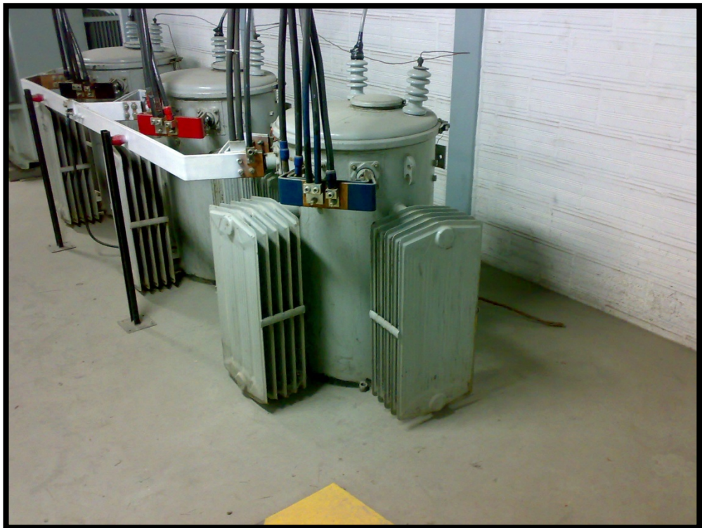
Ilustración 51: Banco de transformadores de 3 x 333Kva / 13.8Y v./ 220v. C/U. Fuente: Autor
