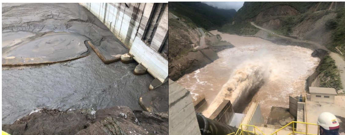
Ilustración 5: Evacuación del agua del embalse.
