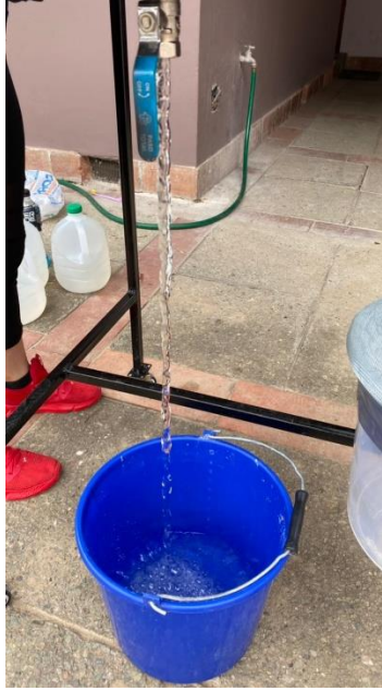
Figura 29: Válvula de desfogue de agua para limpieza
