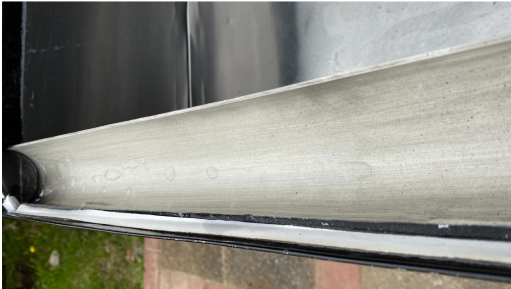
Figura 37: Pequeñas gotas de agua destilada en la canaleta principal
