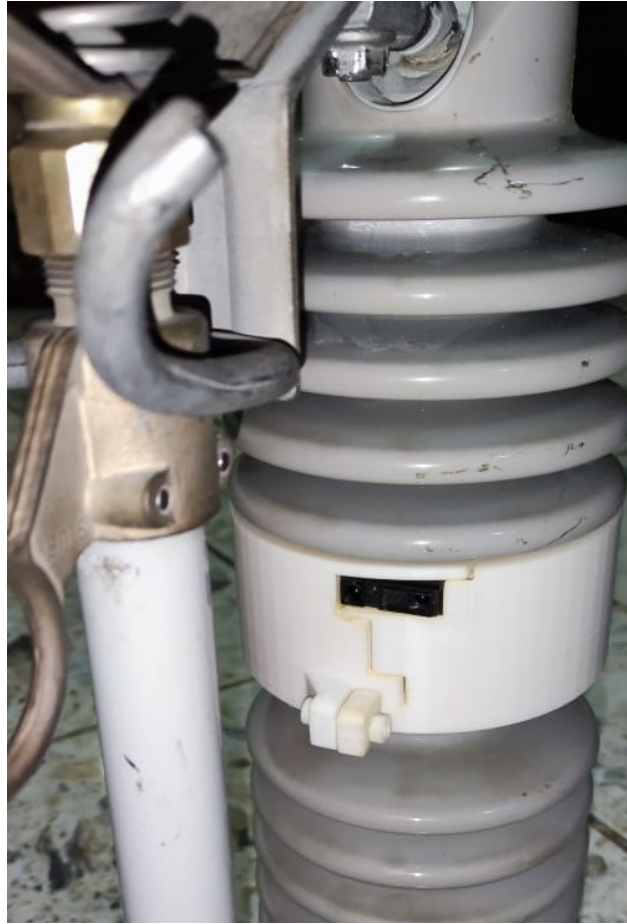
Figura 71: Acople protector colocado (Fuente: Autor)
