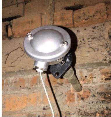
Figura 74. Termocupla tipo K colocada en la pared lateral de la Cámara de combustión del horno.
