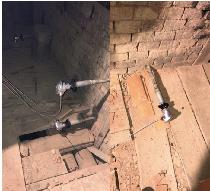
Figura 76. Termocuplas ubicadas en la cámara de combustión del horno de cocción de ladrillos. Fuente:
