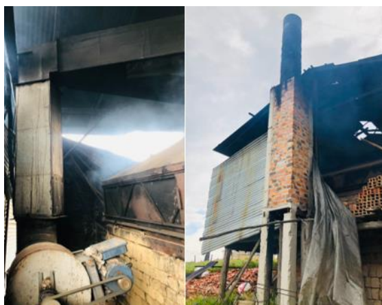
Figura 38. Extractor de gases hacia el medio. Fuente: Autor.
