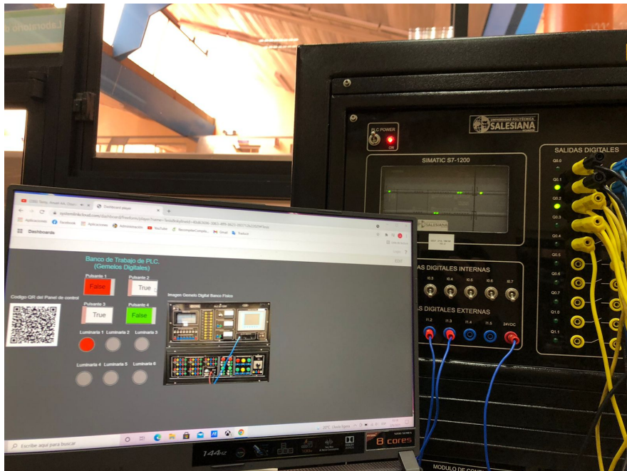
(a) Prueba de la plataforma IoT con las entradas y salidas digitales del PLC
