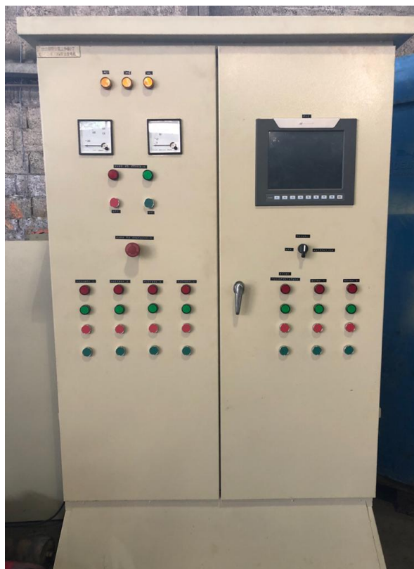
Fig. 60 Parte externa tablero eléctrico.
