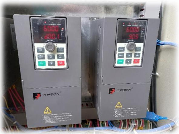
Fig. 83 Variadores de frecuencia en funcionamiento
