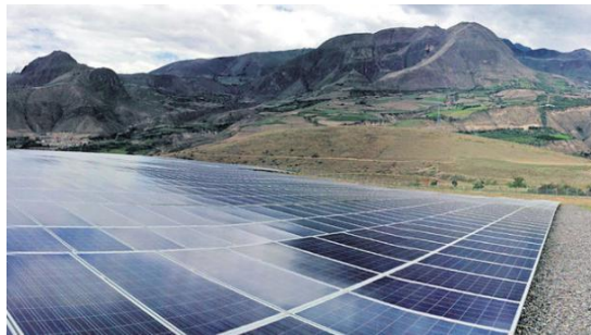
Figura 5.- Planta fotovoltaica en la provincia de Imbabura
