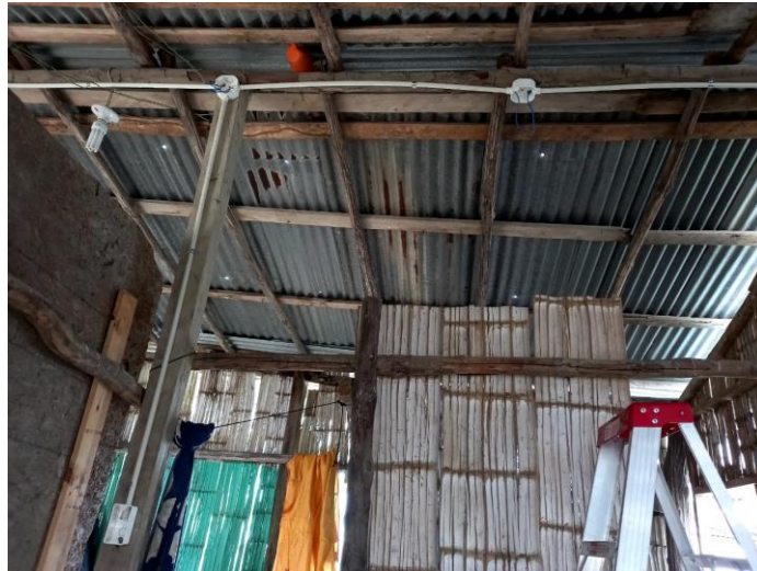
Figura 54.- Cableado electrico en la vivienda Fuente: Autores
